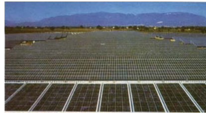
Centrale solare fotovoltaica
